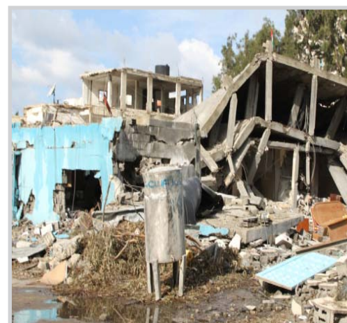
Ødeleggelsene er store og det er mye som skal bygges opp igjen i Gaza.
